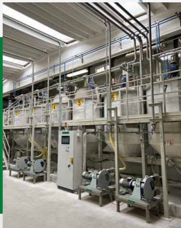
Sistema di pompaggio e gestione • Pumping and management system • Sistema de bombeo y gestión • Système de pompage et de gestion • Sistema de bombeamento e gestão.
