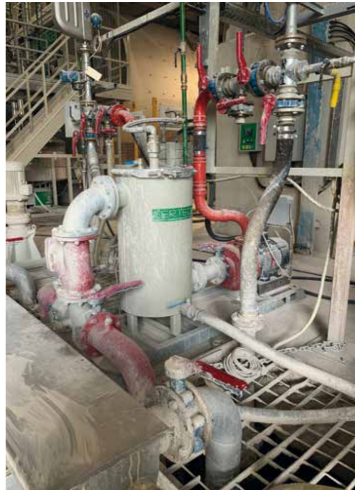
Gruppo di pompaggio per alimentazione barbotina al mulino raffinatoro. Pumping group for slip feeding to the refiner mill. Grupo de bombeo para alimentación barbotina al molino refinador. Groupe de pompage pour alimentation barbotine du broyeur raffineur. Grupo de bombeo para alimentación barbotina al molino refinador.
