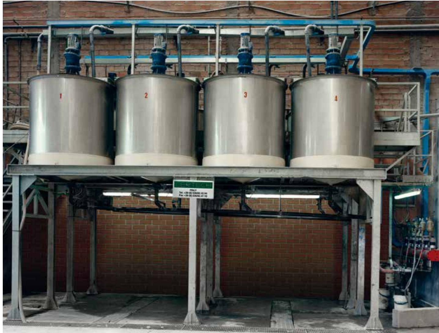
Vasche di contenimento pigmenti complete di agitatore (punto 1). Pigments containing tanks complete with stirrer (point 1). Tanques de contención de pigmentos completas de agitadores (punto 1). Cuves à pigments avec agitateur (point 1). Tanques de contensão de pigmentos completos com agitador (ponto 1).
