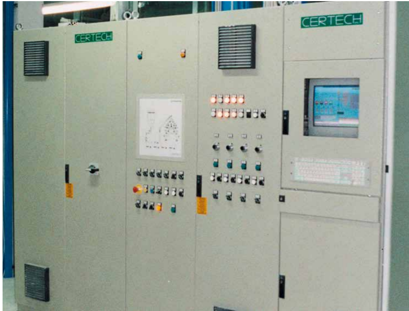
Quadro elettrico generale di comando (punto 7). General control board (point 7). Tablero eléctrico general de mando (punto 7). Tableau électrique de commande général (point 7). Quadro elétrico geral de comando (ponto 7).
