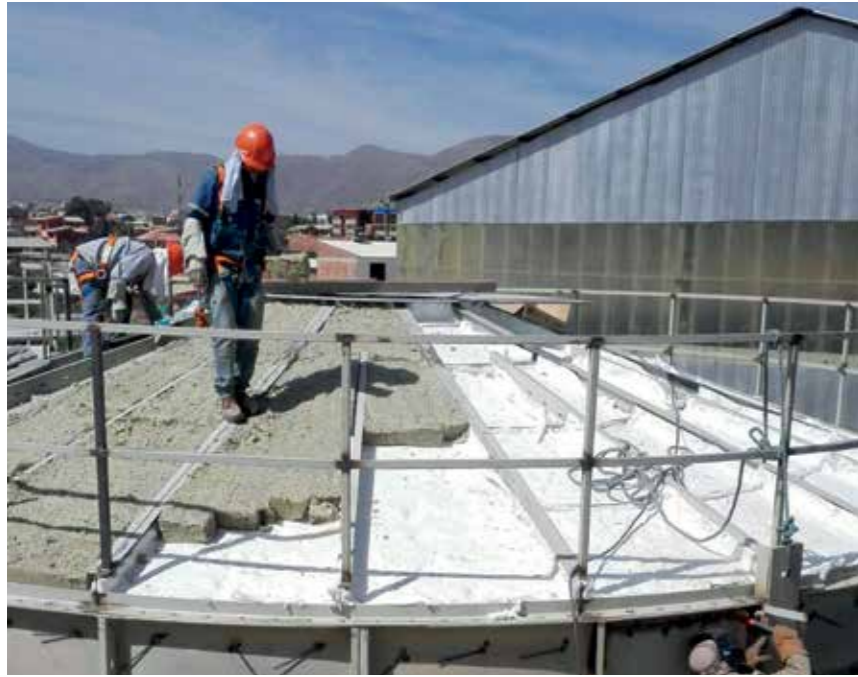
Dettaglio coibentazione cappello CSD 10.000. Primo strato in fibra ceramica e secondo strato in fibra minerale. Detail of the CSD 10.000 cap insulation. First layer in ceramic fibre and second layer in mineral fibre. Detalle aislamiento sombrero CSD 10.000. Primera capa en fibra cerámica y segunda capa en fibra mineral. Détail isolation chapeau CSD 10.000. Première couche en fibre céramique et seconde couche en fibre minérale. Detalhe do isolamento da chapéu CSD 10.000. Primeira camada em fibra cerâmica e segunda camada em fibra mineral.
