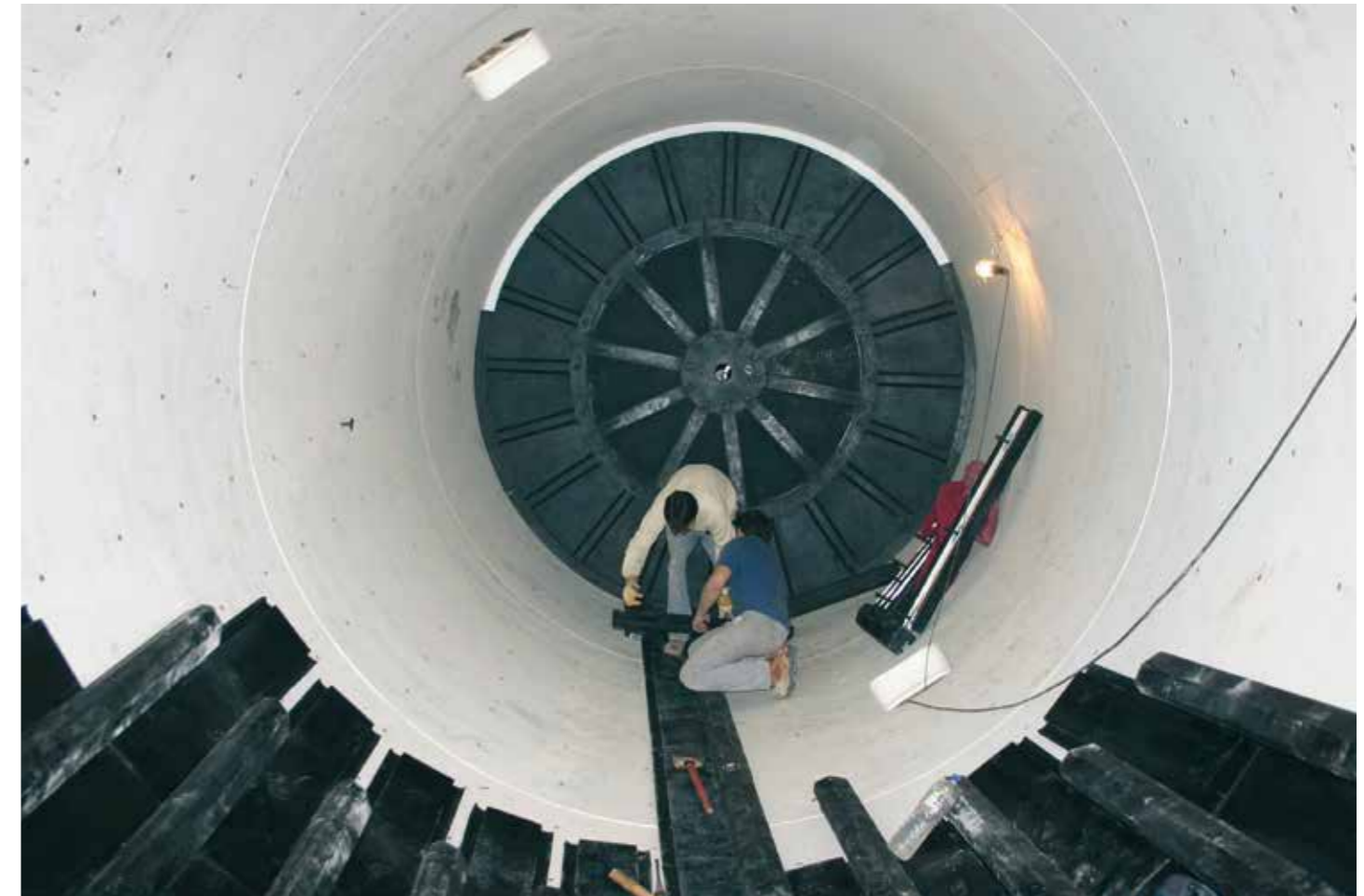
Montaggio del rivestimento in gomma in un mulino con capacità di 160.000 litri. Installation of the rubber lining on a mill with a capacity of 160,000 litres. Montaje del revestimiento de goma de un molino con capacidad de 160.000 litros. Montage du revêtement en caoutchouc dans un broyeur doté d'une capacité de 160.000 litres. Montagem do revestimento em borracha em um moinho com capacidade de 160.000 litros.
